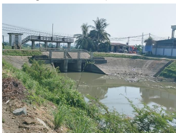
(Cuối tuyến kênh - Công T3)
