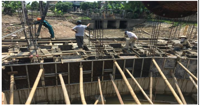
Sàn đặt máy bơm
