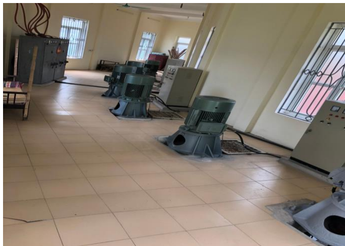
Thiết bị trong nhà trạm
