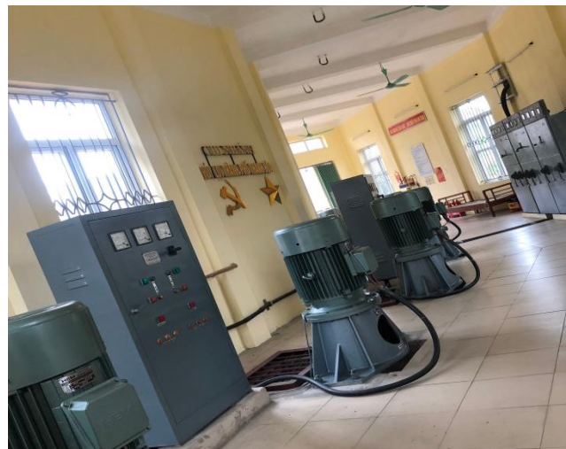
Thiết bị trong nhà máy
