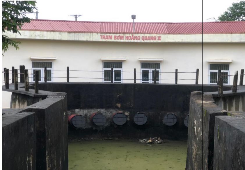
Chính diện bể xả
